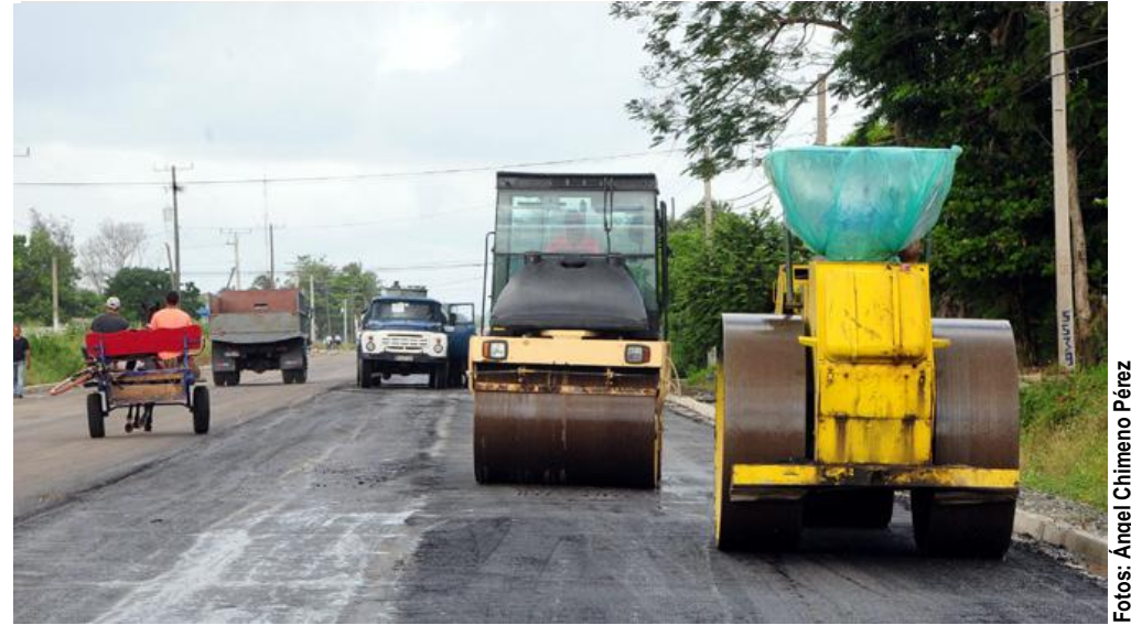
El tráfico de diferentes medios de transporte en el área de labor amenaza la integridad física de los trabajadores y la calidad de la obra.
