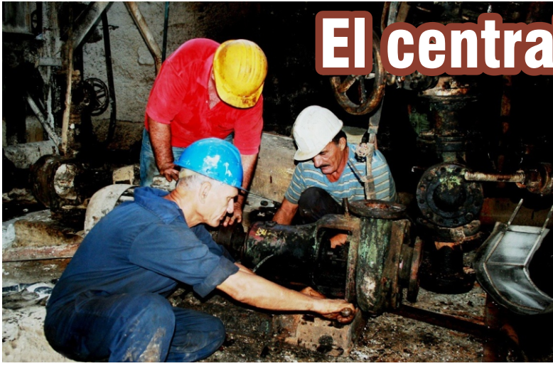
Trabajo intenso para alistar las bombas que intervendrán en el proceso productivo.
